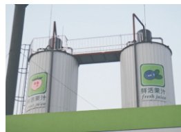
厭氧塔廢水處理
