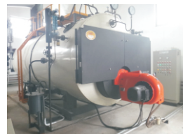
柴油鍋爐將改裝為天然氣鍋爐
