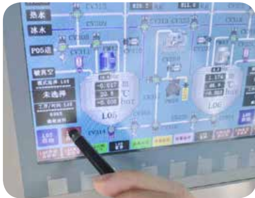
③ 點擊停止灌裝進料按鈕，底部三通閥復位，算好冷卻罐排污閥打開。
